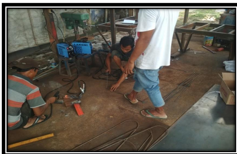
Gambar 2. Pelaksanaan Praktik Las oleh Pemuda Desa Aikmual Kecamatan Praya Sumber: Dokumentasi Kantor Desa Aikmual Kecamatan Praya 2020
